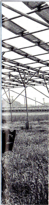
トラクターなど農業機械を支障なく運用できるよう、太陽光パネルは十分な高さ（最低2.5以上）に設置される＝千葉エコ・エネルギー提供
