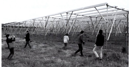
匝瑳メガソーラーシェアリング第一発電所
