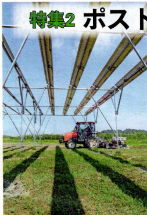
千葉県匝瑳市メガソーラーシェアリング第一発電所(千葉県匝瑳市)より
